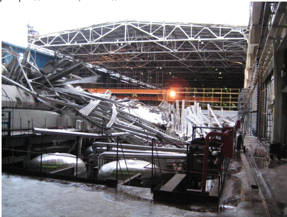
Рис. 1. Общий вид машинного зала СУГРЭС-2 после аварии (г. Сургут).
