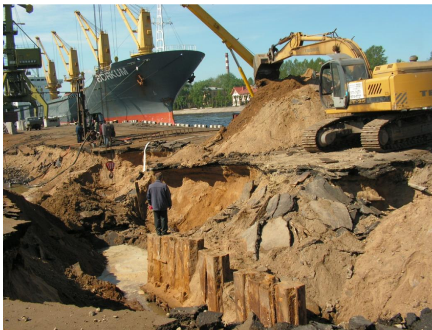
Рис. 2. Общий вид причала №21 Морского порта Санкт-Петербурга после аварии.
