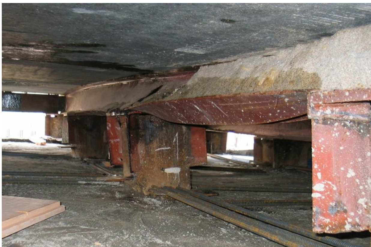
Рис. Деформация конструкций эксплуатируемого сооружения в зоне влияния вновь возводимого сооружения.
