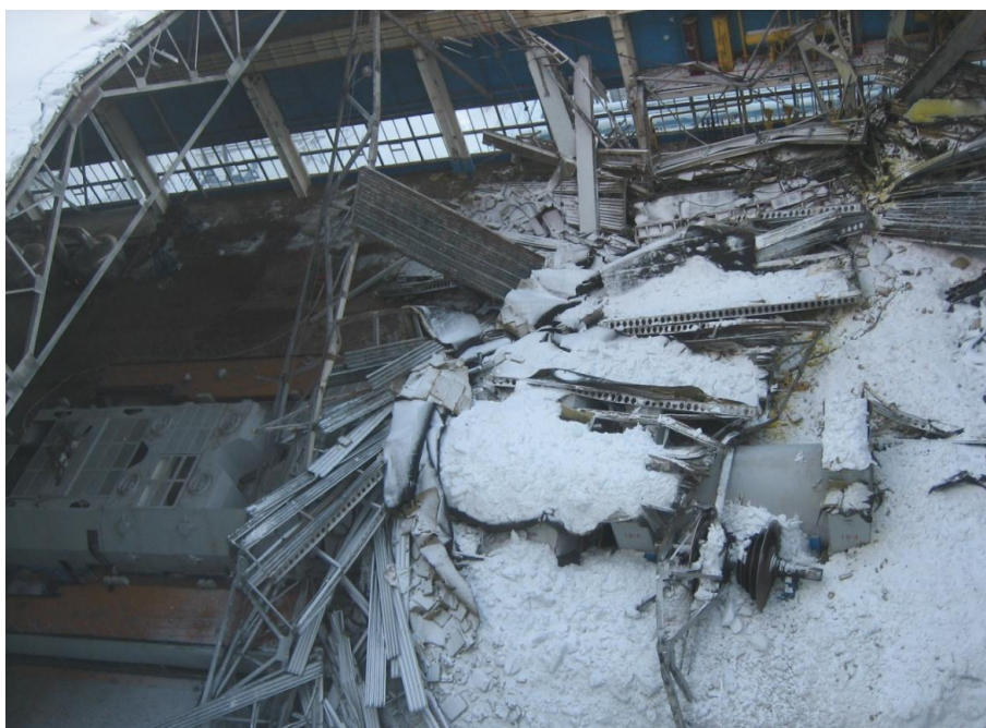
Рис. 1. Обрушение кровли машинного зала СУГРЭС-2 (г. Сургут).
