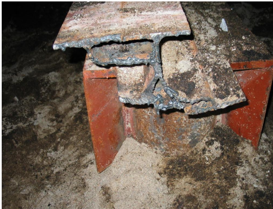
Рис. 2. Деформация стальных конструкций фундамента стального резервуара V=30000 \text{ м}^3 при проведении гидравлических испытаний (Беломорская нефтебаза).
