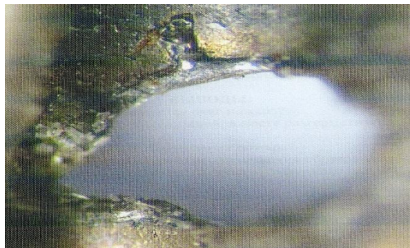
Рис. 11. Прожег сильфонного шланга в результате утечки тока а) участок сильфонного шланга с прожегом (стрелкой указано сквозное отверстие) б) Крупный план сквозного отверстия в гофрошланге (МБС-22, увеличение 56 x ) Видны следы электрических эрозивных процессов
