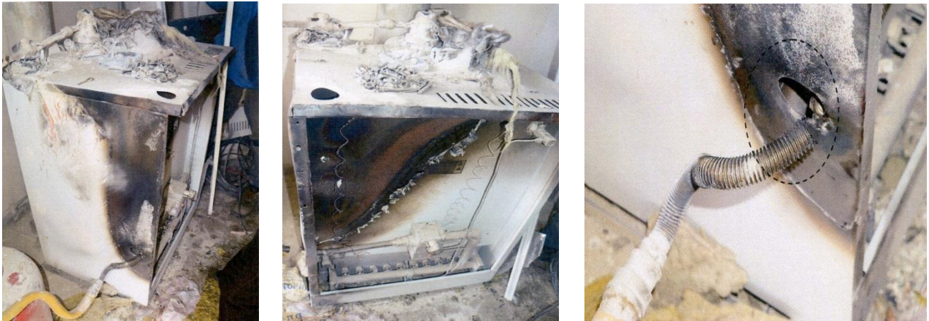
Рис. 8. а,б,в а) –левая стенка котла; б- задняя стенка котла в) - место прохода шланга через левую стенку котла
