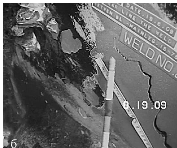
Рис. 1. Трещина, обнаруженная в ходе обследования морской платформы
